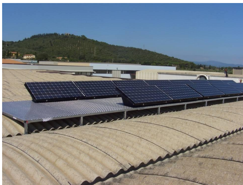
Figura 16 - Esempio di installazione non idonea alla classificazione dell'impianto fotovoltaico nella categoria "su edifici" – Motivazione: i moduli fotovoltaici non sono appoggiati alla superficie di copertura.
