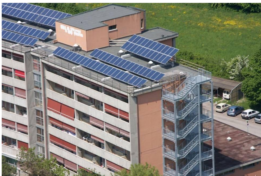
Figura 5 - Esempio di installazione non idonea alla classificazione dell’impianto fotovoltaico nella categoria “su edifici” – Motivazione: l’elemento perimetrale non può essere considerato balaustra e la quota massima dei moduli supera i 30 cm
