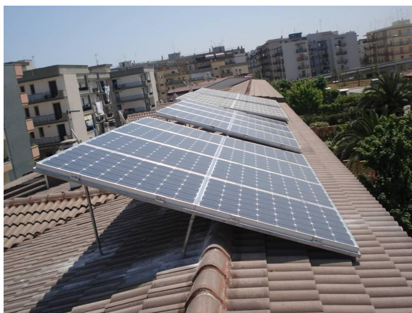
Figura 10 - Esempio di installazione non idonea alla classificazione dell'impianto fotovoltaico nella categoria "su edifici" – Motivazione: i moduli non rispettano la geometria della falda di copertura
